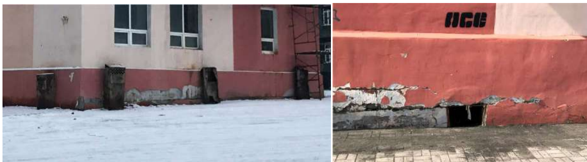
Рис. 4, 5. Фотофиксация - отверстие в цокольной стене с утраченной шахтой для вентилирования.
